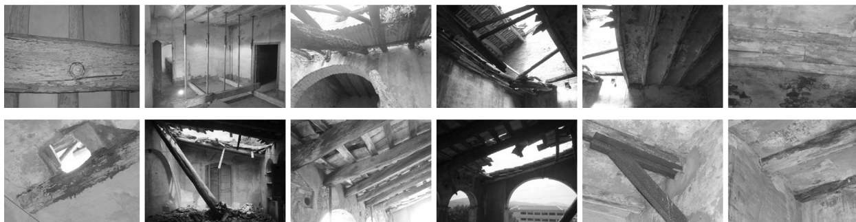
Plànol i imatges de l'estudi de les patologies dels sostres i cobertes de la planta primera
